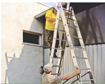
Zapewnienie asekuracji przez drugą osobę przy wchodzeniu i schodzeniu z drabiny.
